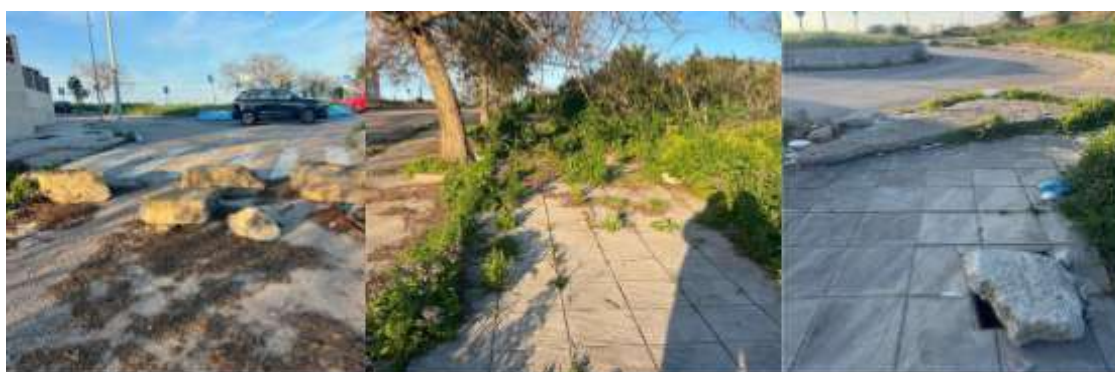
27. Mantenimiento deficiente. Calle Manuel Moreno Rojas. Cd: 11204.
