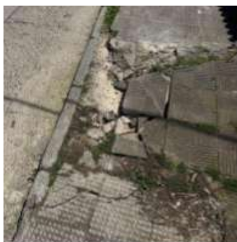
15. Acerado en mal estado. Calle Sagrado Corazón. Cd: 11203
