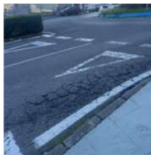
17. Carretera en mal estado. Avenida virgen de la Palma
