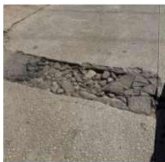
16. Carretera en mal estado. Calle Sagrado Corazón. Cd 11203
