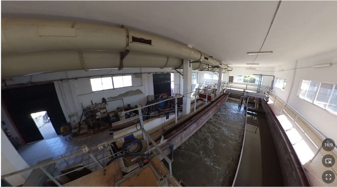
Sala de Pretatamiento
