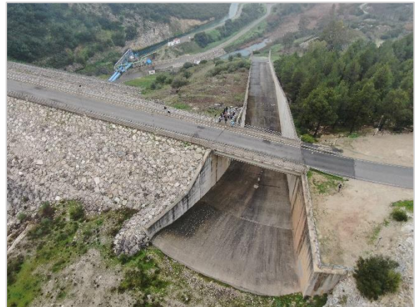
Fotografía 43. Aliviadero de labio fijo y perfil creager.
