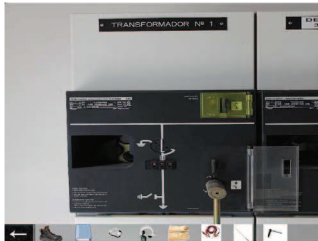
Figura 4. Momento en que el alumno se encuentra en el Transformador
